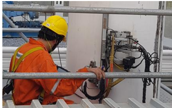
Mapeo de corrosión (C-Scan)
